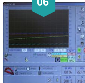
06/ sistema de control
